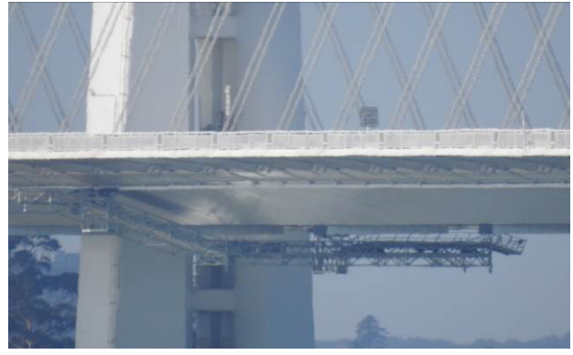
箱梁下方設置維修檢測桁架
