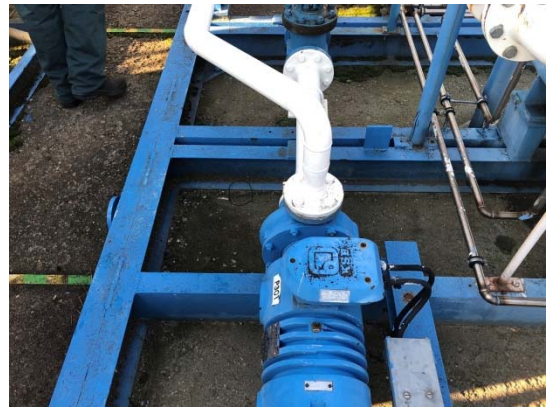
圖 9. Return Pump (打回儲槽)
