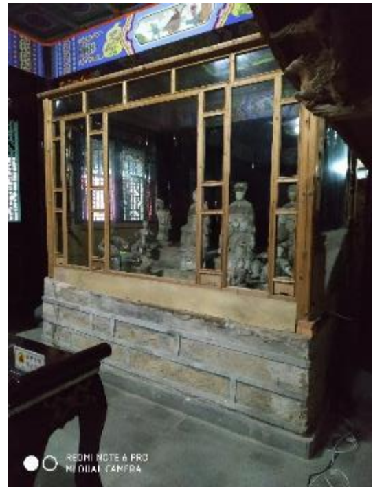
燈光規劃不良，造成玻璃罩反光，妨礙觀察，且現場展示說明不足，場地維護感覺亦不足(五)
