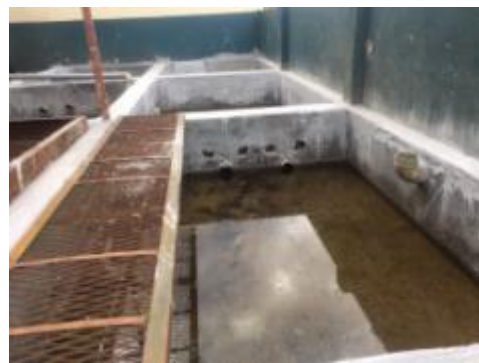
圖 16. 咖啡的廢水處理設備
