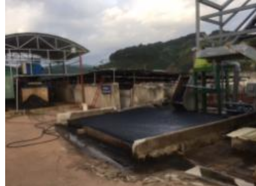
圖 17. 咖啡的廢水處理設備
