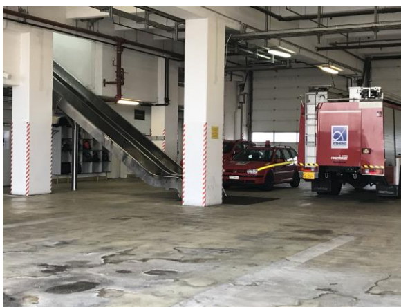
圖 18：消防員緊急出勤溜滑梯
