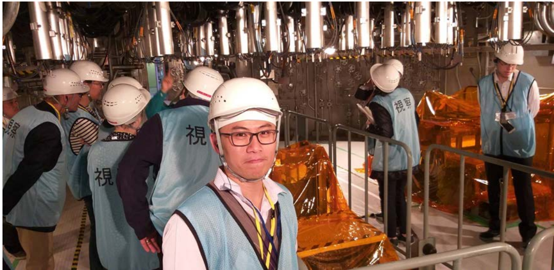
圖 23：島根核能電廠 3 號機爐心儀殼(IN CORE HOUSING) 現場設備
