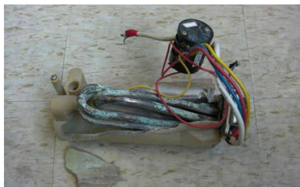
圖 51 熱水膽爆裂處(內側)
