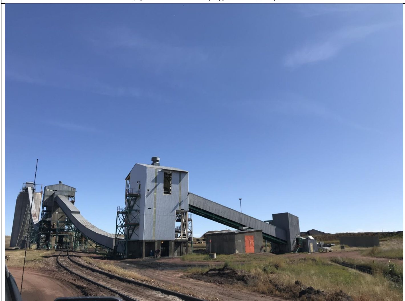
圖4-7：Decker煤礦CHPP區域碎篩設備
