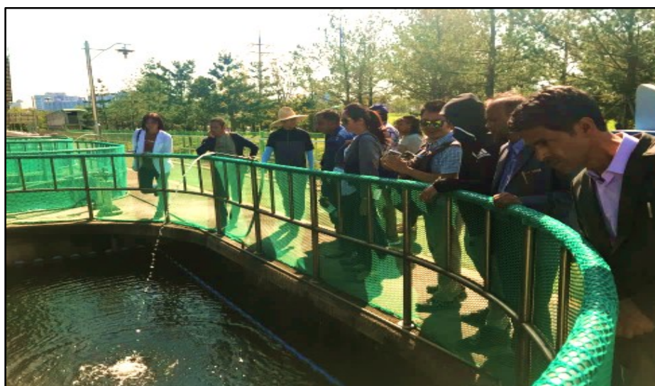
照片 16 初級曝氣沉沙池( grit and aeration separator tank) 運作模式及設備
