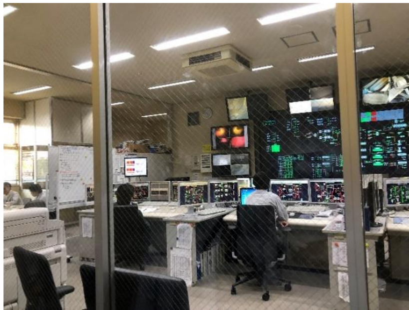
圖 3.2.3 自動化中央控制室
