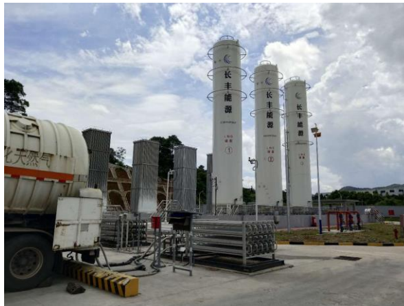
圖 5、中小型 LNG 供氣站
