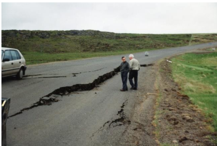
圖 2-3.6 地震造成道路毀損
