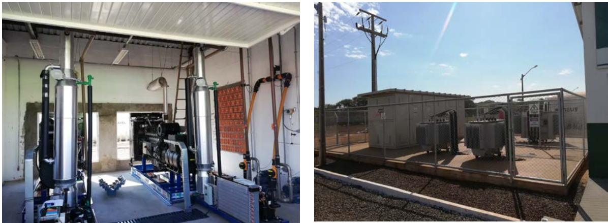
圖 2-12 沼氣發電機組與貯能設備
