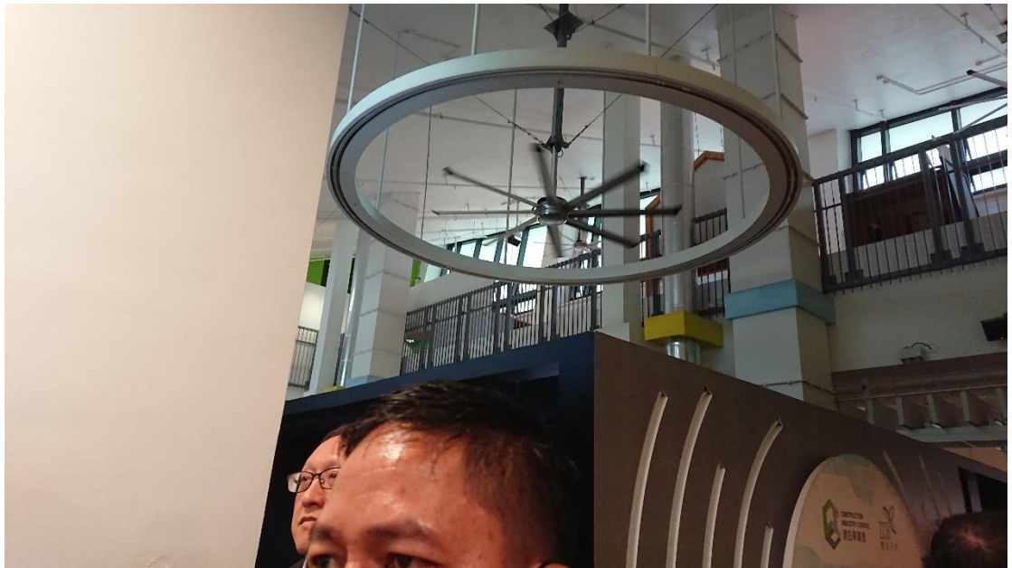
建造產業協會零碳建築內空調均勻用吊扇
