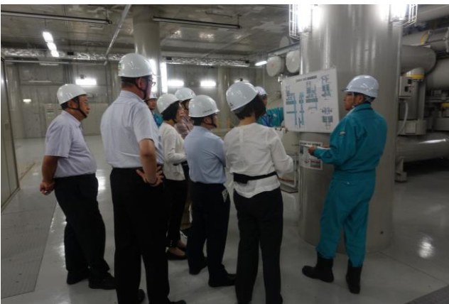
廣島電力所 GIS 現勘
