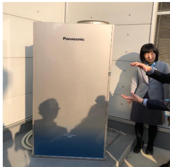
圖 18 松下 5Kw 氫燃料電池設備
