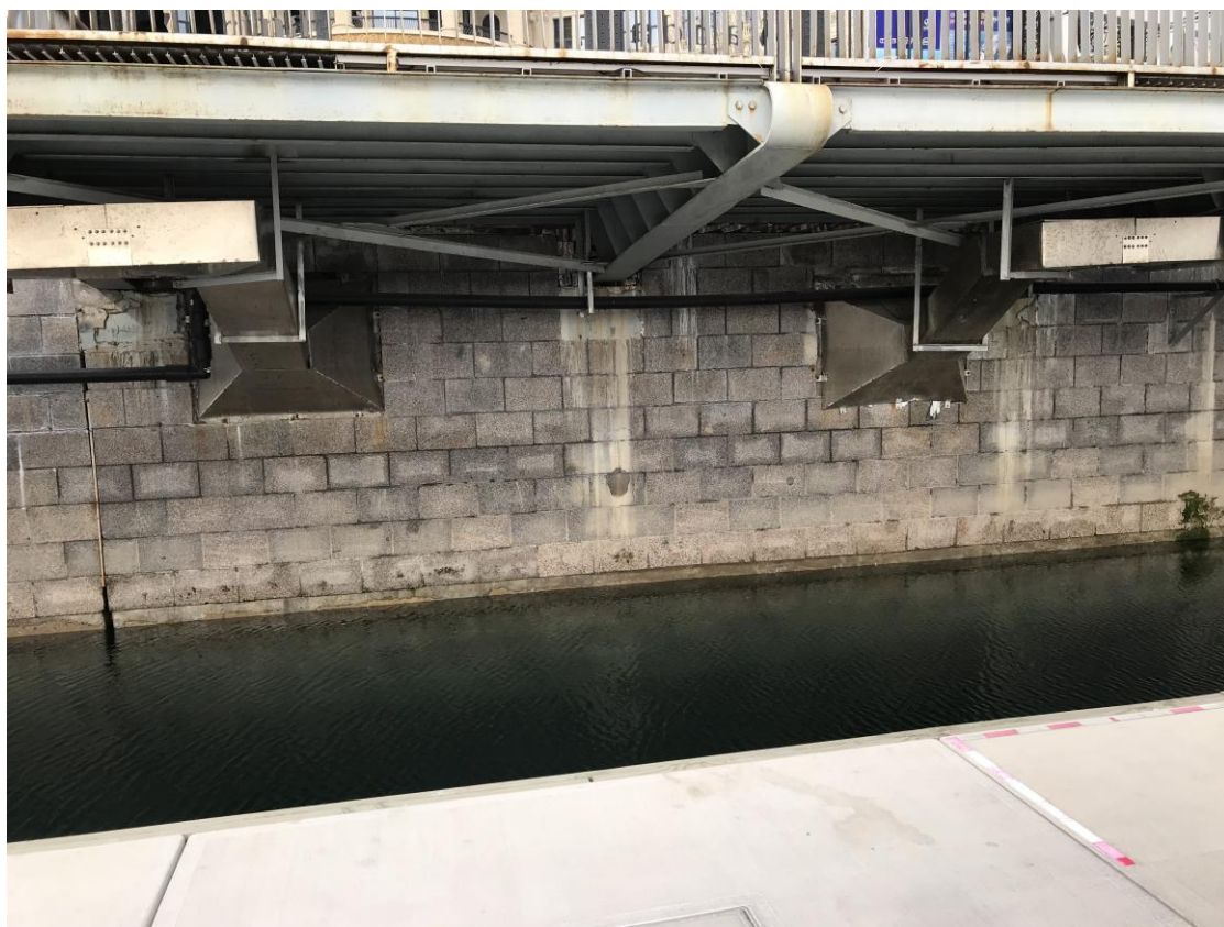
遊艇碼頭岸水電與後線連接設施
