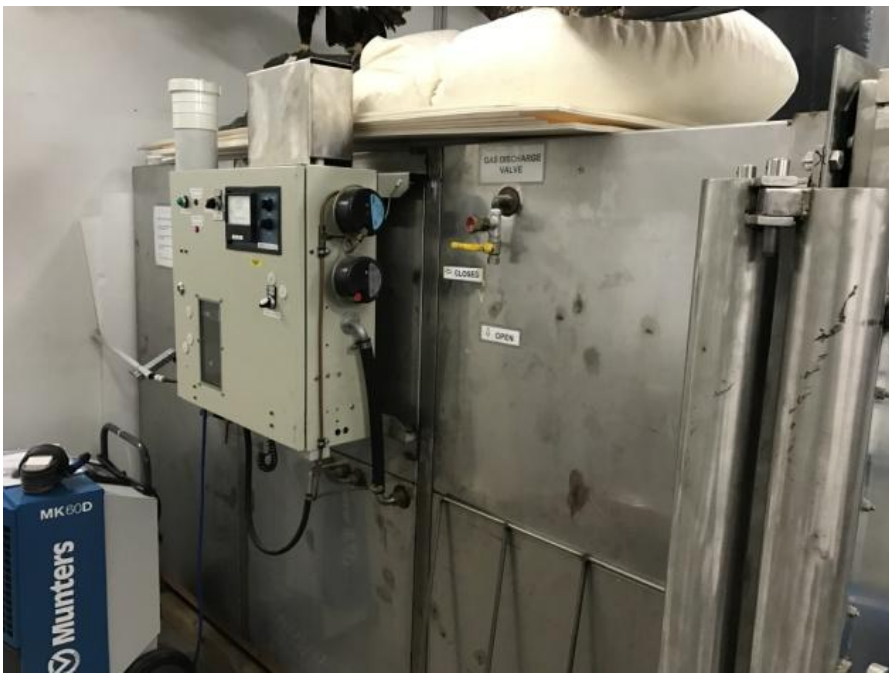
圖十二、氮氣除蟲設備
