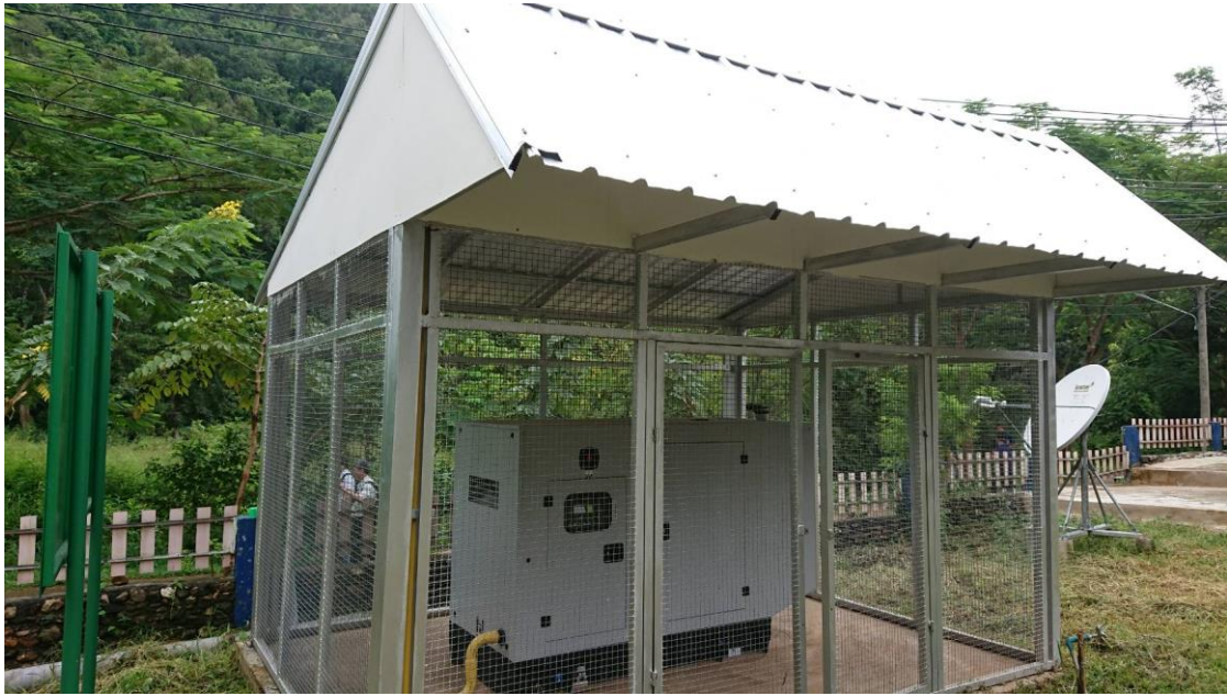
圖 52、示範計畫備用柴油發電裝置
