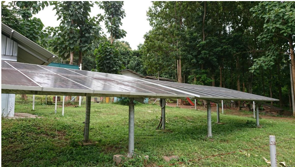
圖 51、示範計畫太陽能發電裝置
