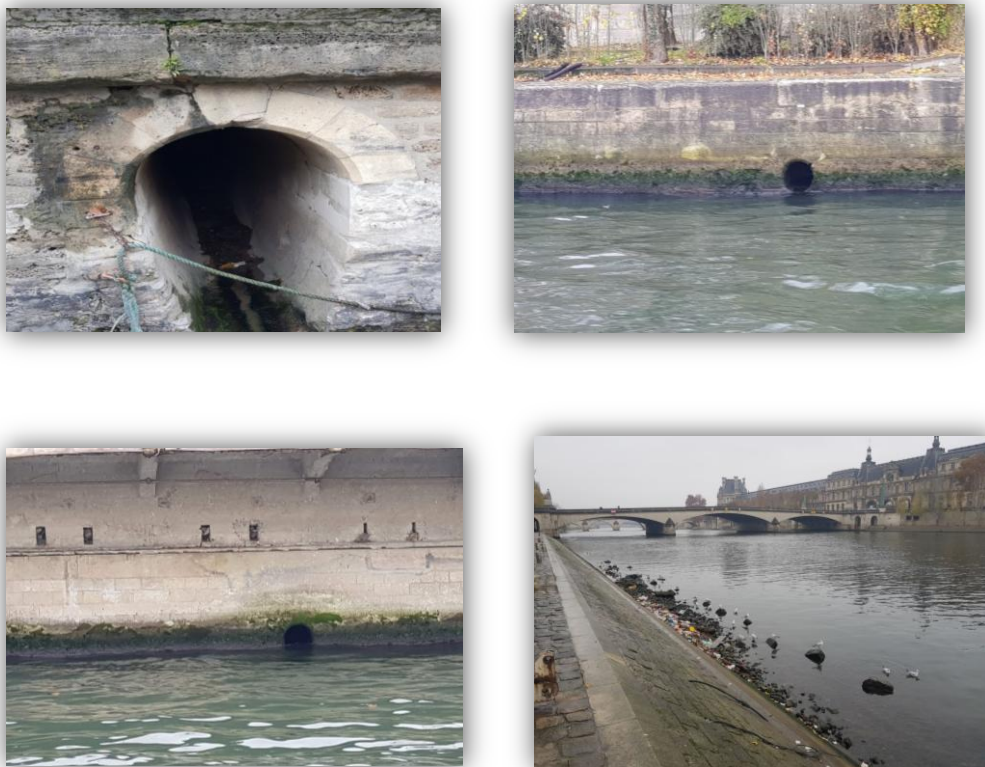
圖 4 塞納河沿岸水利設施
