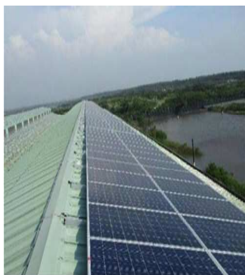
圖 11 臺南市在城西固化廠屋頂設太陽能板平均每天可發一千九百度電。(圖片來源：臺南市政府環保局)
