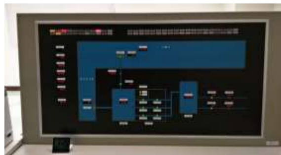
H.自動控制監測設備
