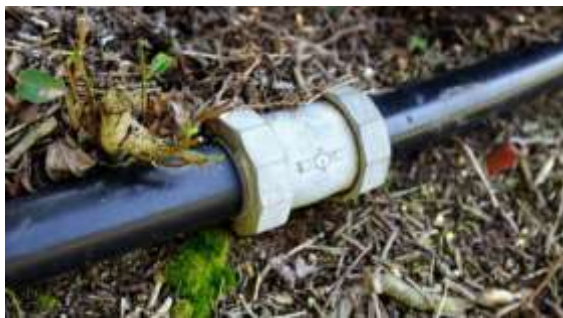
G. 末端管路設備
