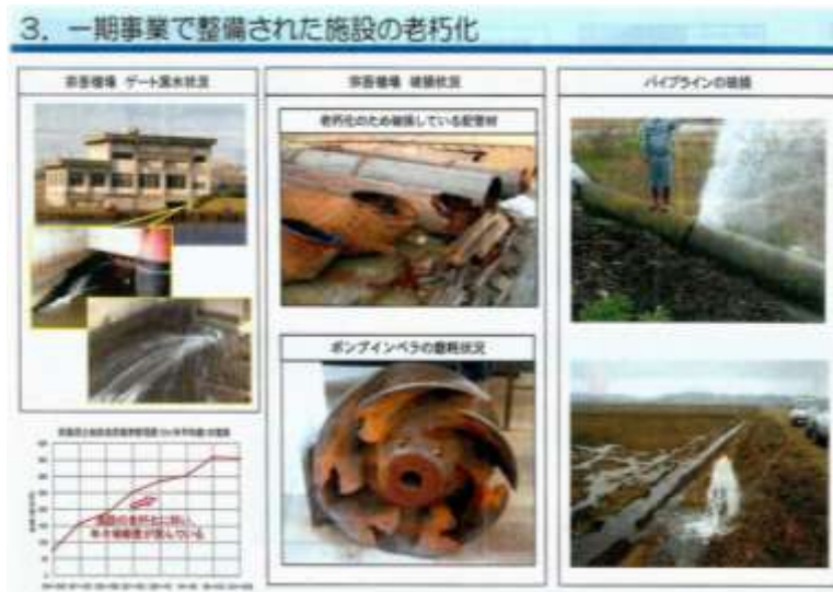
圖 3-28 印旛沼一期農業水利施設老舊損壞一覽
