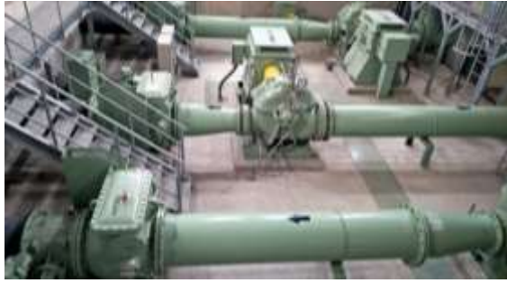
A.抽水機設備
