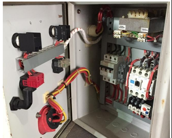
變電箱內部配置
