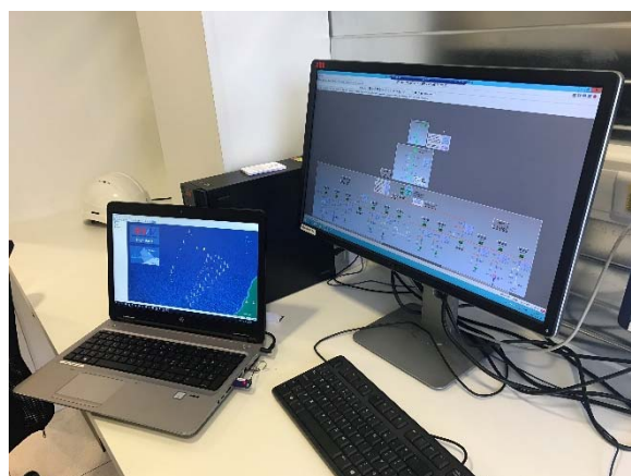
SCADA 監控螢幕
