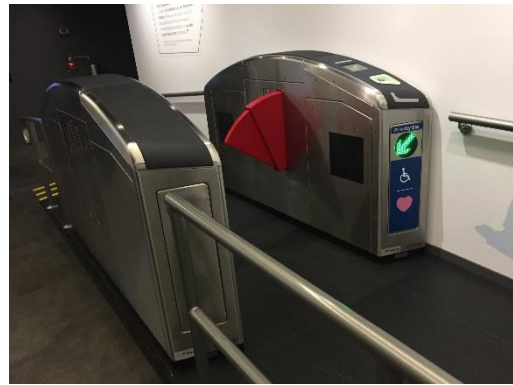
圖 33 無障礙通行閘門
