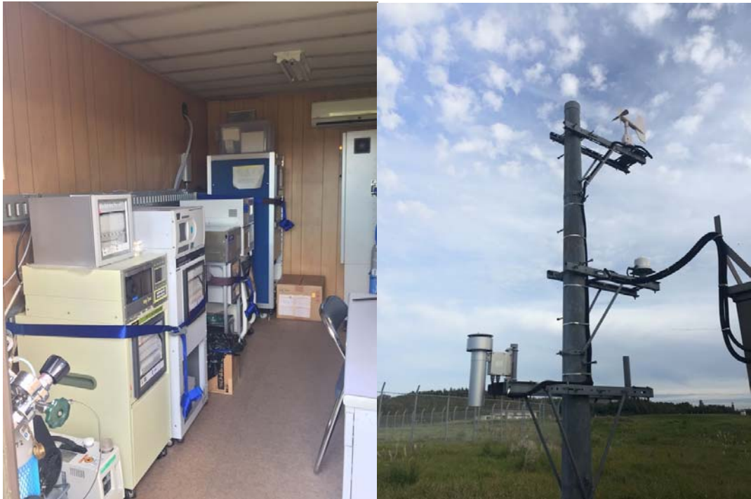
圖十七、成田國際機場環境監測站測儀器塔及設備室
