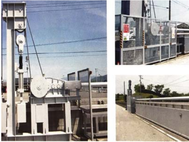
陸閘自動關閉裝置
