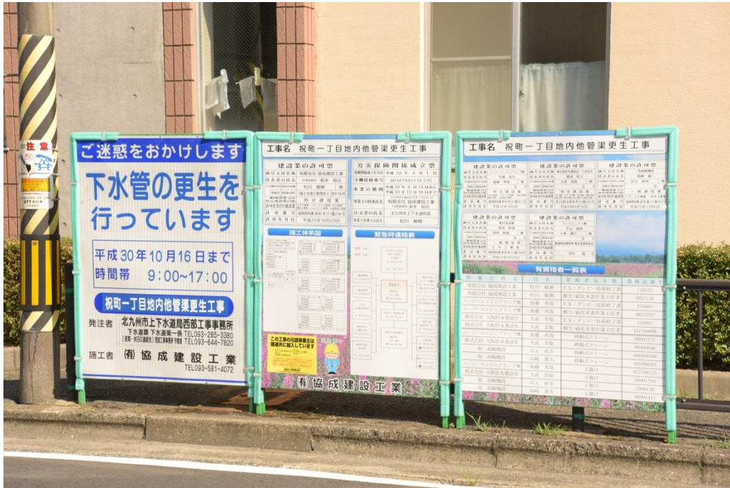
圖 36 施工訊息公告
