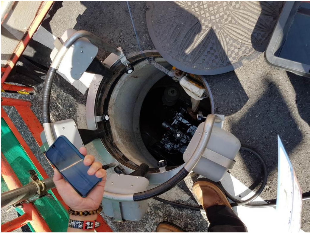
圖 38 下水道換氣設備
