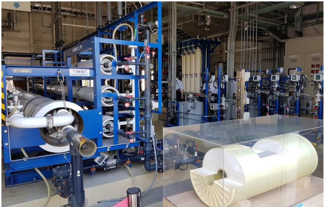
圖 21 UF 膜/RO 膜處理設備
