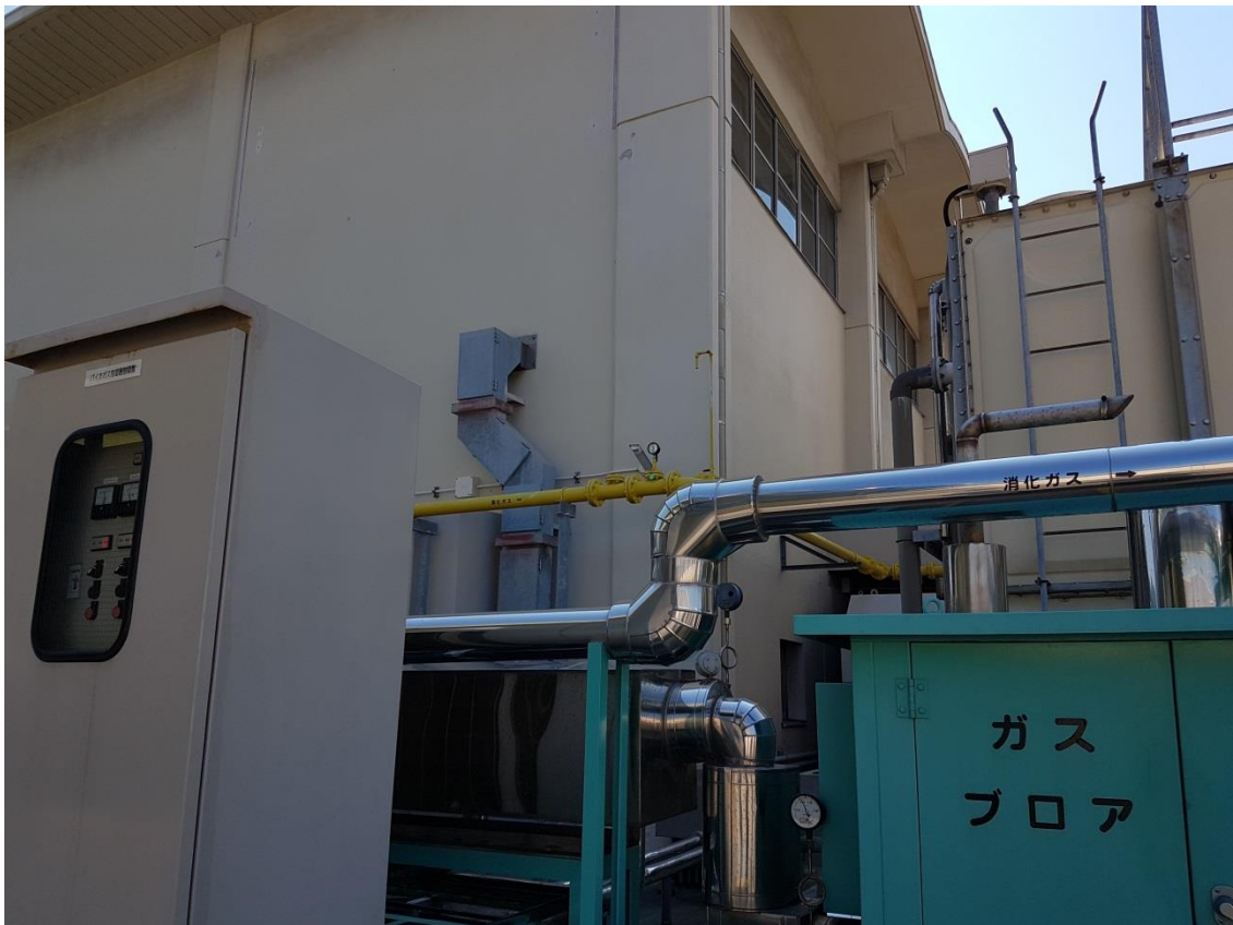
圖 47 沼氣脫硫設備
