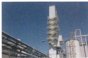
液体酸素・窒素製造設備
