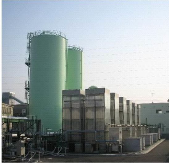
圖 8 Sowa LNG 衛星站
