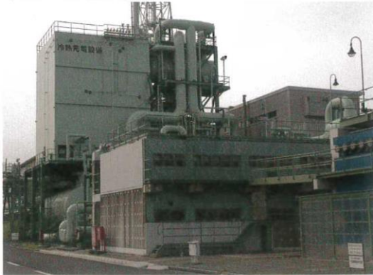
冷熱発電設備(外観)
