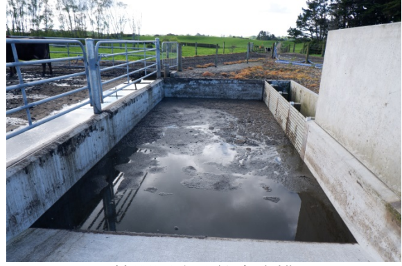
簡單固液分離廢水槽
