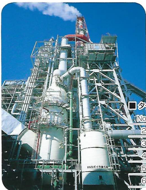
9号ボイラー No. 9 boiler
