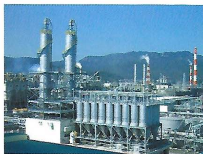
三酢酸セルローズ(TAC)製造設備
