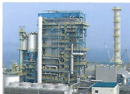
循環流動層ボイラー設備
