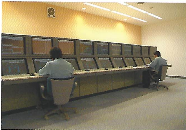
プラントを集中管理するコントロールルーム
