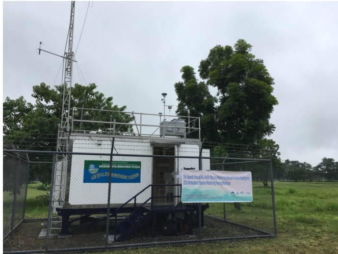
圖 7 於克拉克基地-空氣品質監測站參訪我國協助建置之汞濕沉降採樣點
