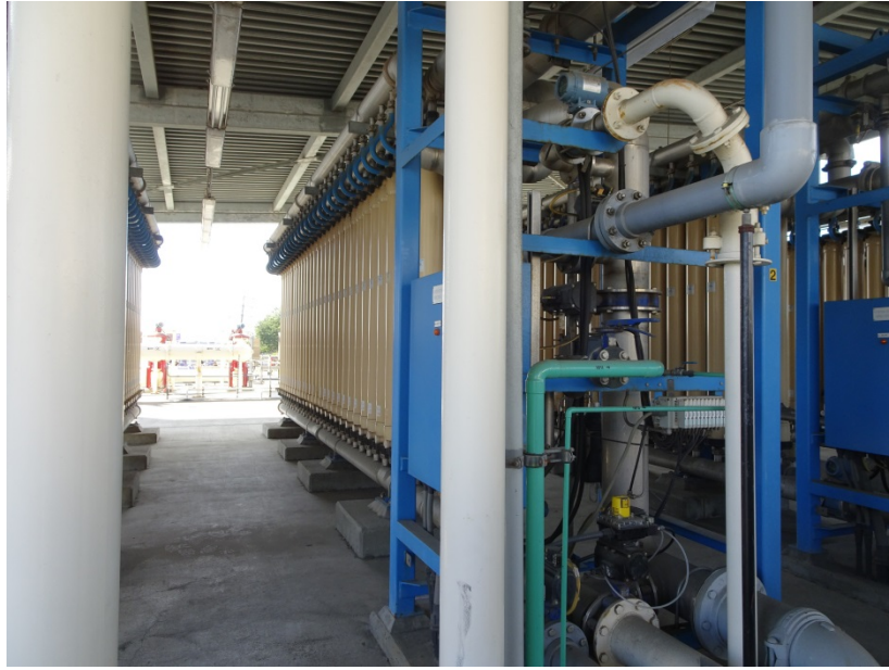
圖3.4-6 污水廠逆滲透設施
