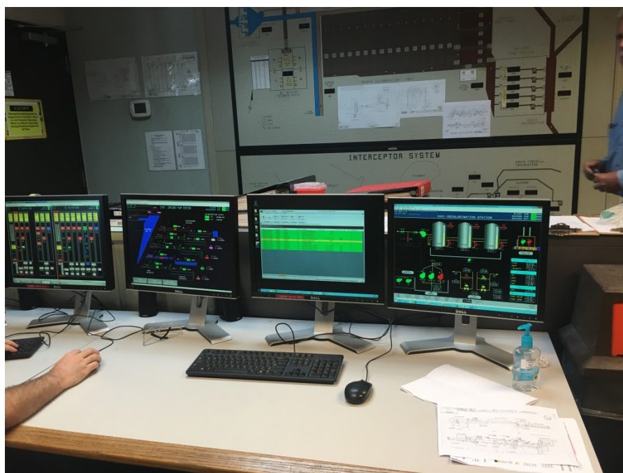
圖3.4-1 污水廠控制中心
