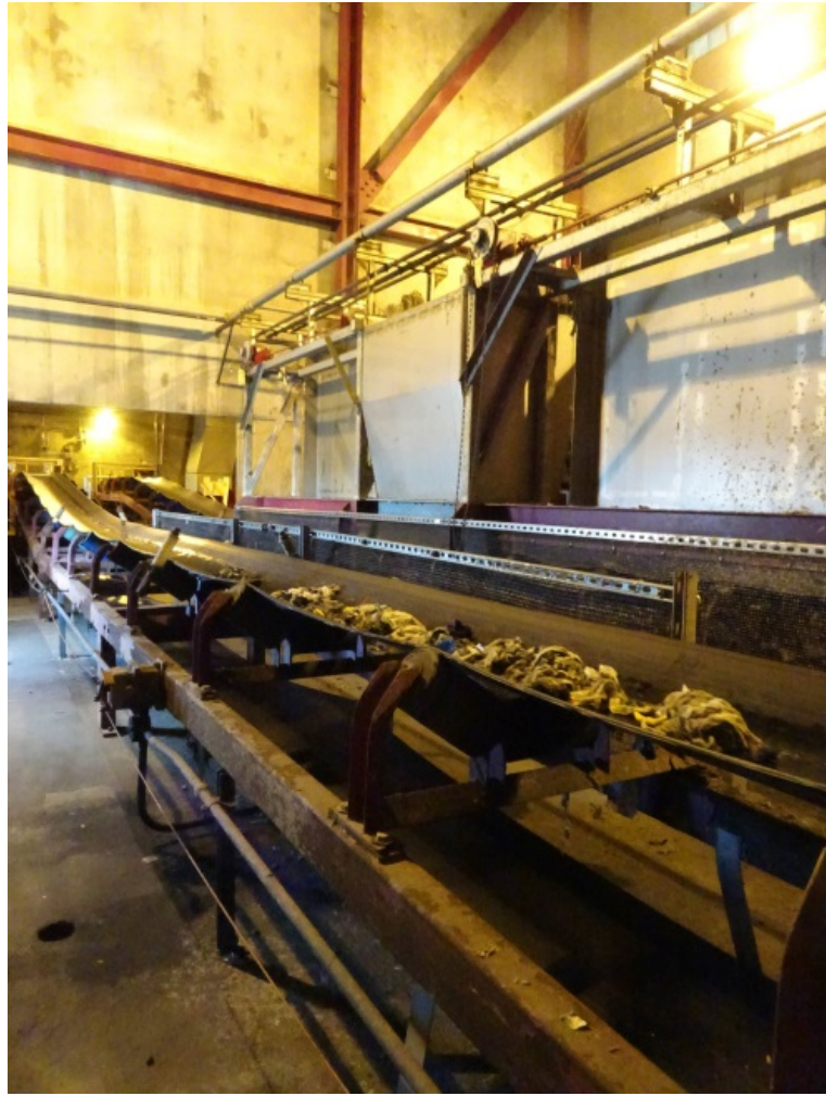
圖3.4-2 污水廠攔污柵
