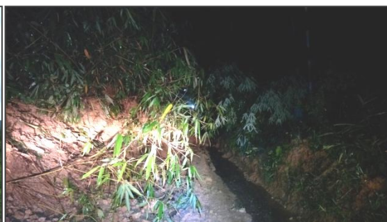
圖 124、在克倫邦遇到山路邊坡坍方
