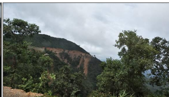
圖 88、拓寬造成的崩塌侵蝕
