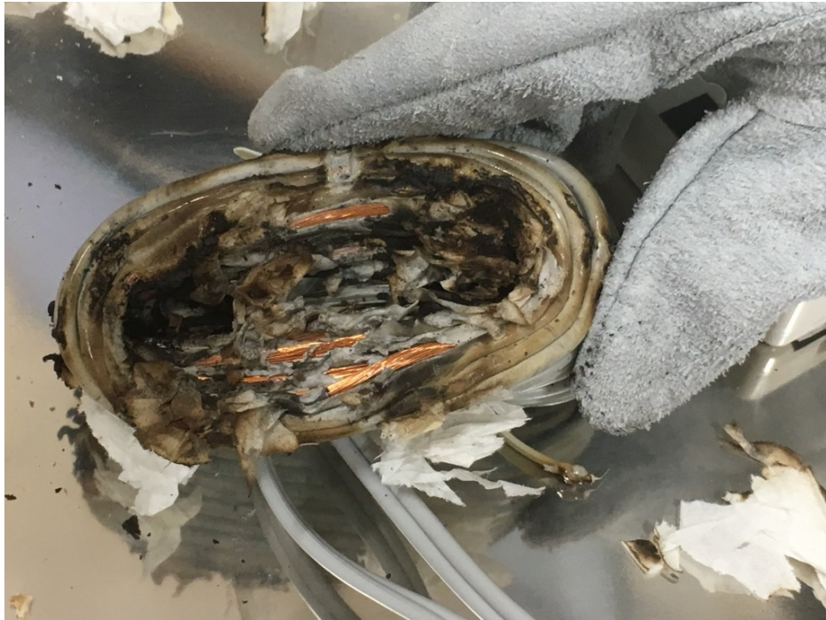
圖 18.電源線塑膠外殼燒熔、內部銅線外露
