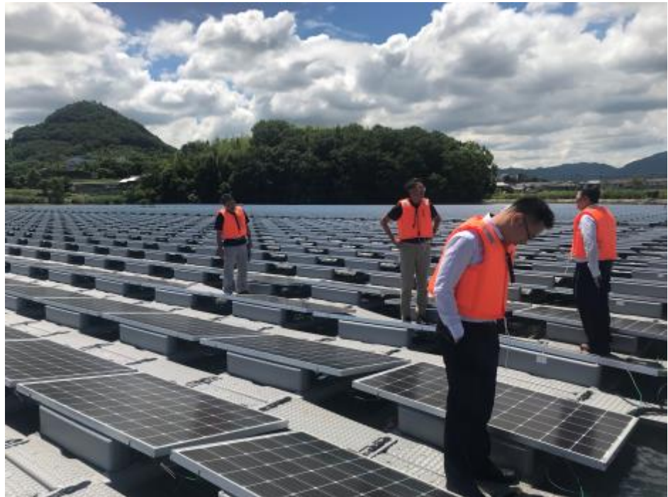
圖 13：參訪平木尾池水上太陽光發電所-1
