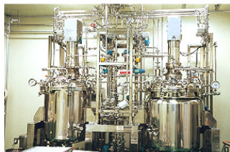
自動滅液製造設備
