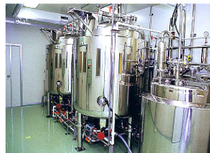
精製水製造設備
