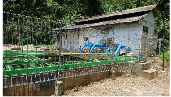
圖 15 原先即已設置之取水設施 與加壓站
