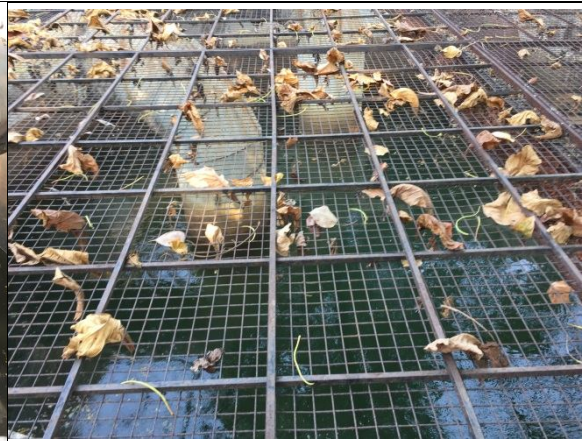
圖 46 Kilpauk WTP 分水井(2)
