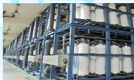
Kao-tan WTP UF Unit
