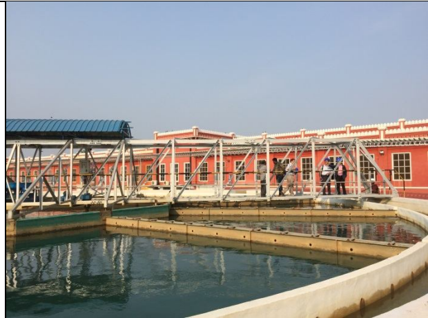
圖 55 Kilpauk WTP 快速膠凝沉澱池(2)
