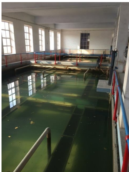
圖 54 Kilpauk WTP 快濾池
