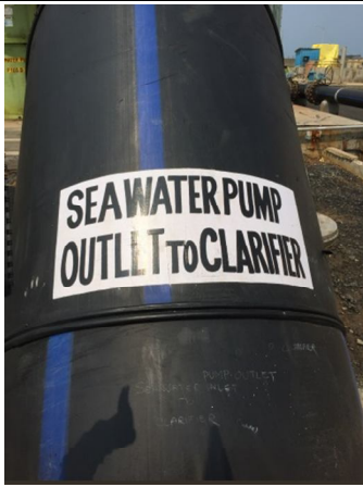
圖 28 原水送水管至快速沉澱膠凝池
