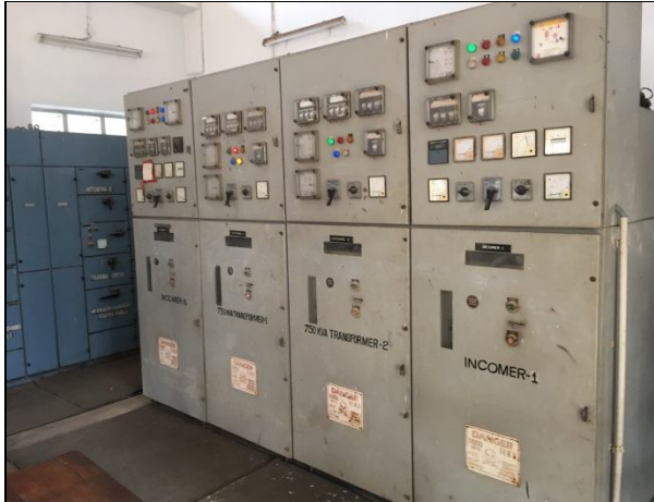
圖 51 Kilpauk WTP 設備控制盤
