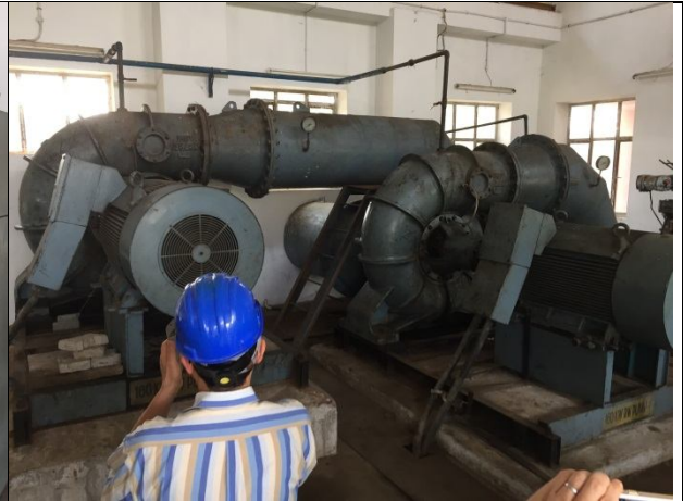
圖 52 Kilpauk WTP 抽水機
