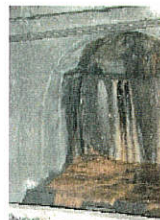
避車洞嚴重滲水
