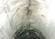
頂拱縱向裂縫
