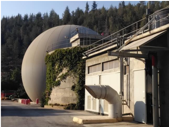
圖 3-13、甲烷貯留設備
