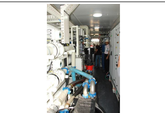
圖 3-54、貨櫃式海水淡化設備內部情形
