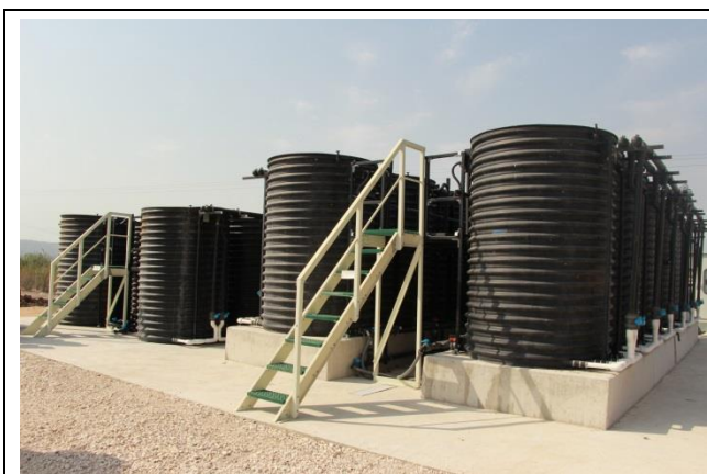
圖 3-51、Fluence 公司生物水處理設施
