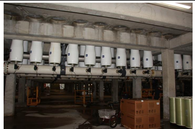
圖 3-38、Sorek 海淡廠內部膜組設置情形
