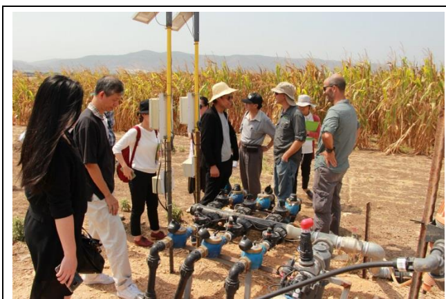
圖 3-49、農業供水管及水表裝設情形
