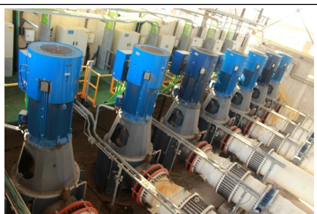
圖 3-34、Sorek 海淡廠送水加壓站
