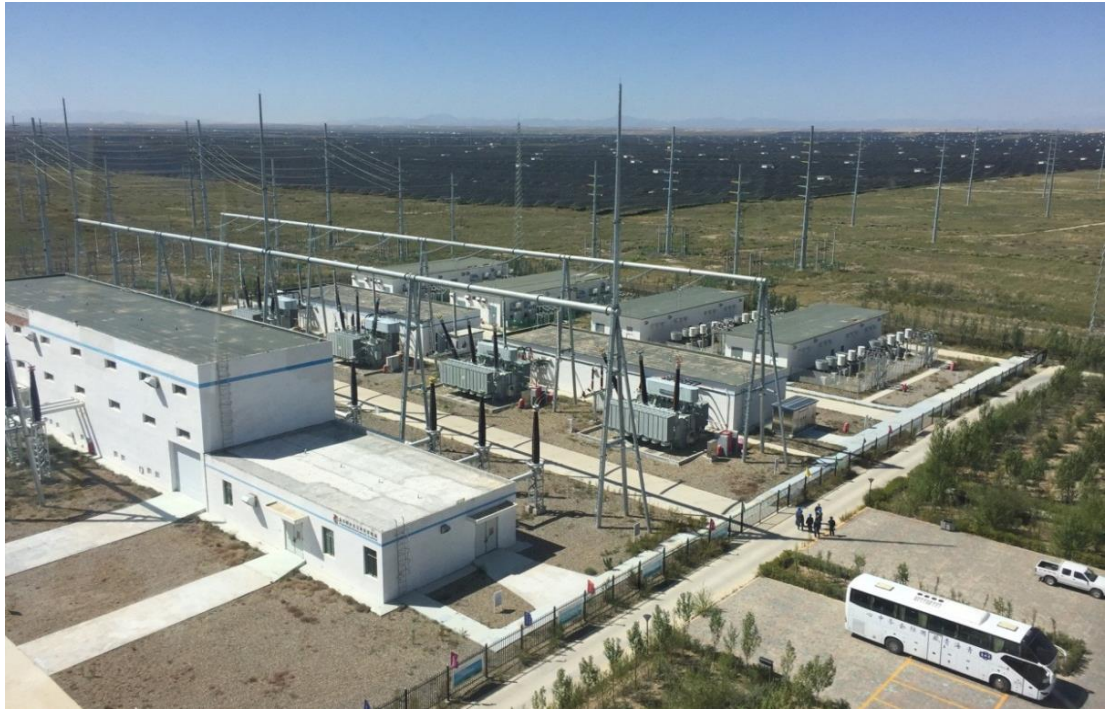
圖 10 變電所之一隅
