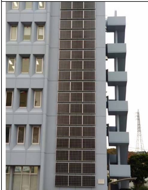
綜合大樓牆面裝設有太陽能板
