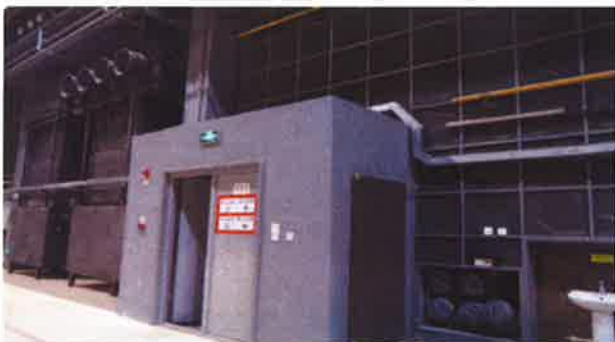
圖 12 空調回風系統、電設備
