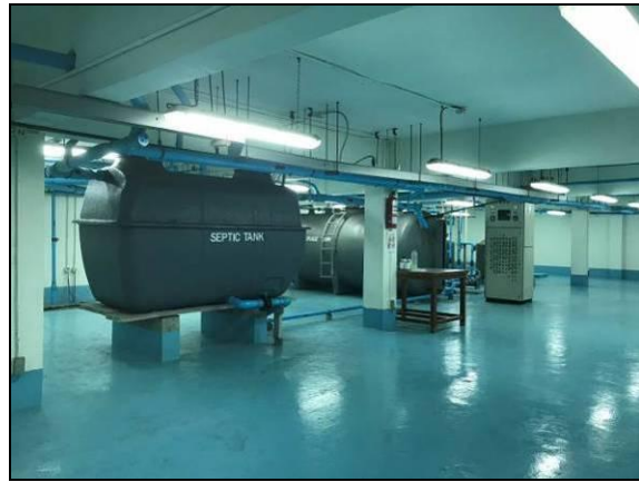
圖 46. 實驗室廢水處理系統 (酸鹼處理)
