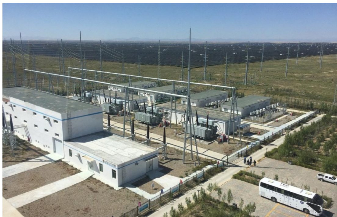
圖 10 變電所之一隅
