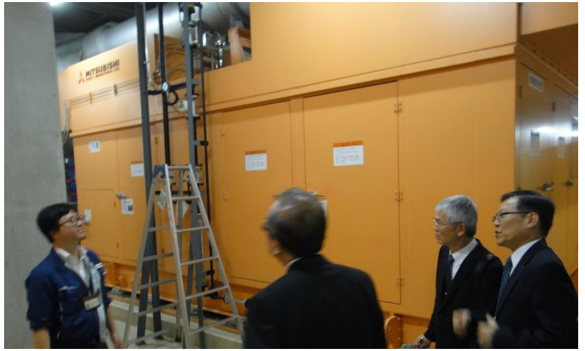
圖 10 中城大樓機電設施(1/2)
