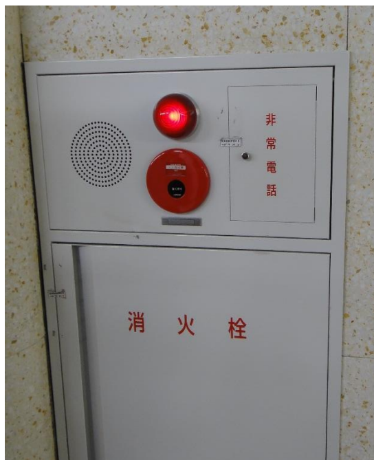
圖 21 滅火栓與緊急電話
