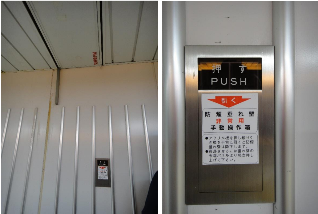
圖 22 車站內防煙設備
