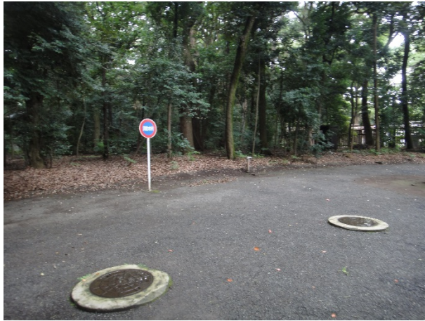
圖 18 消防水利設施
