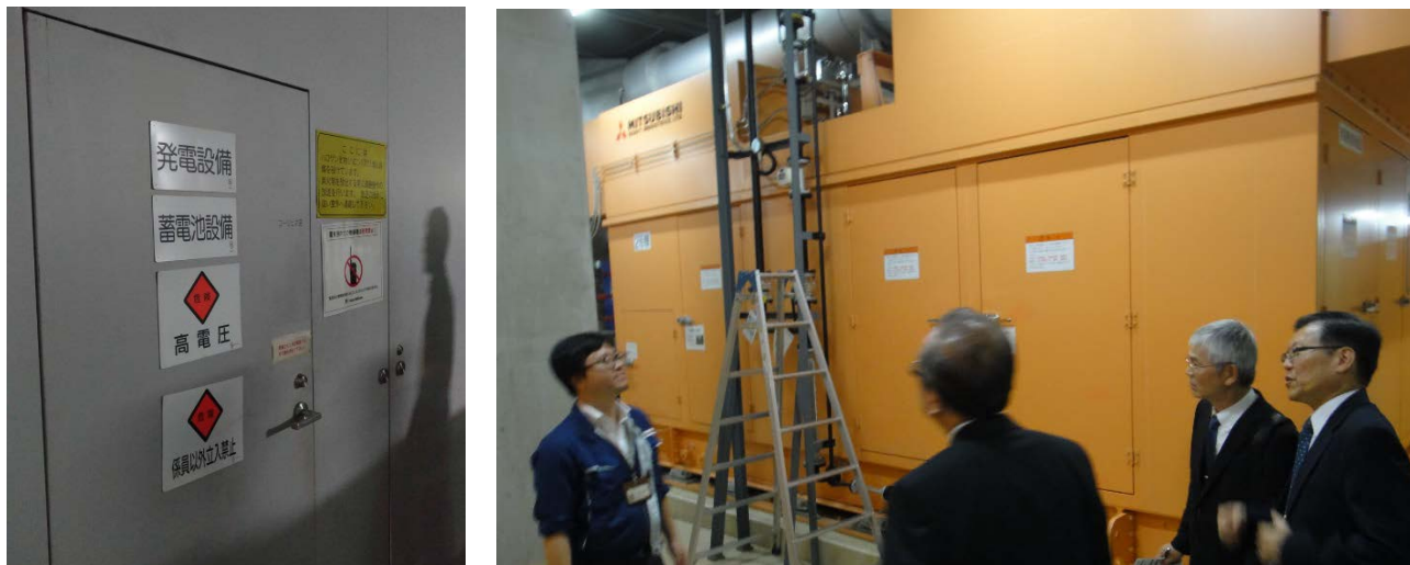
圖 9. 中城大樓機電設施(1/2)
