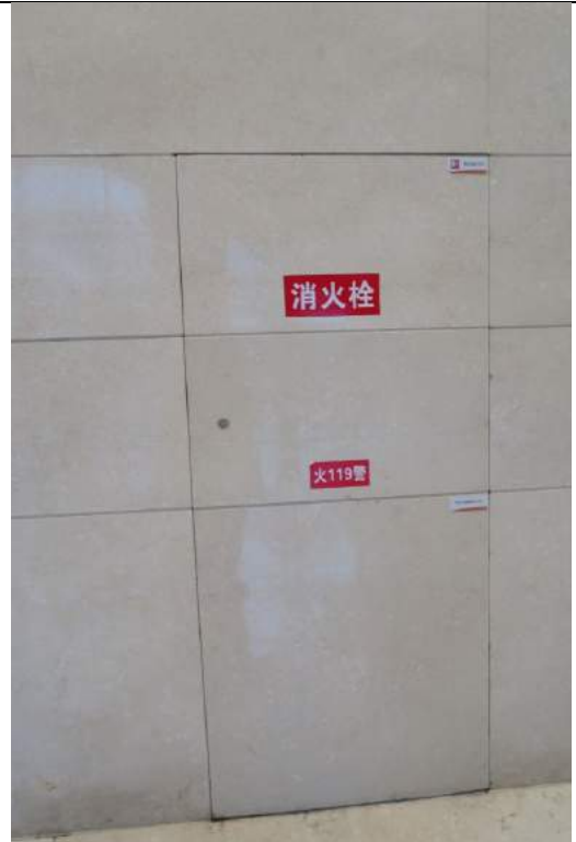
消防設備融入整體館舍設計美觀。
