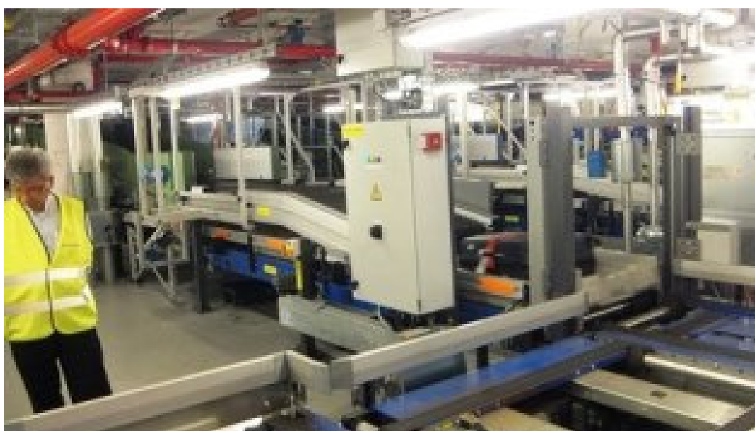
圖 54：杜賽道夫機場 ICS 設備實測
