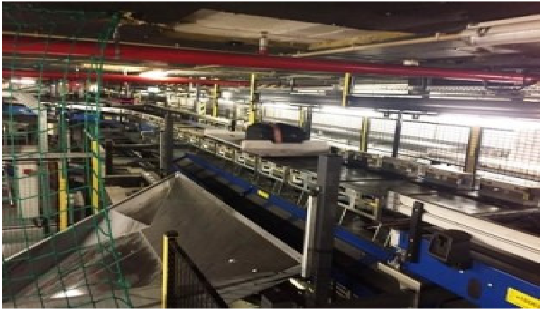
圖 56：杜賽道夫機場 ICS 設備實測
